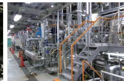
医薬品製造プラント Pharmaceutical Manufacturing Plant
